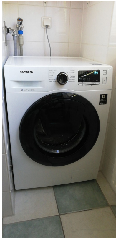
Waschmaschinenanschluss im Bad
