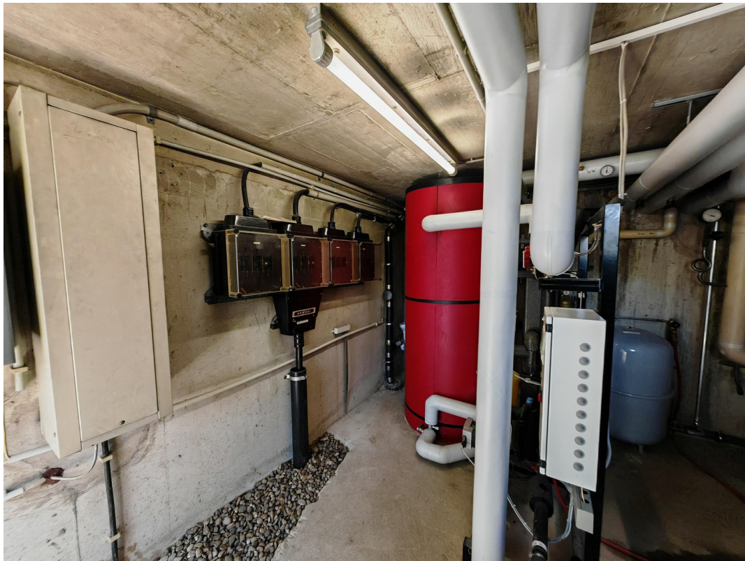
Fernwärme mit Übergabestation
