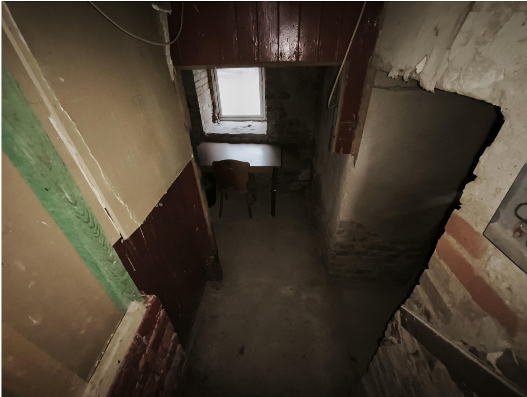
Kleiner Keller mit Öltanks
