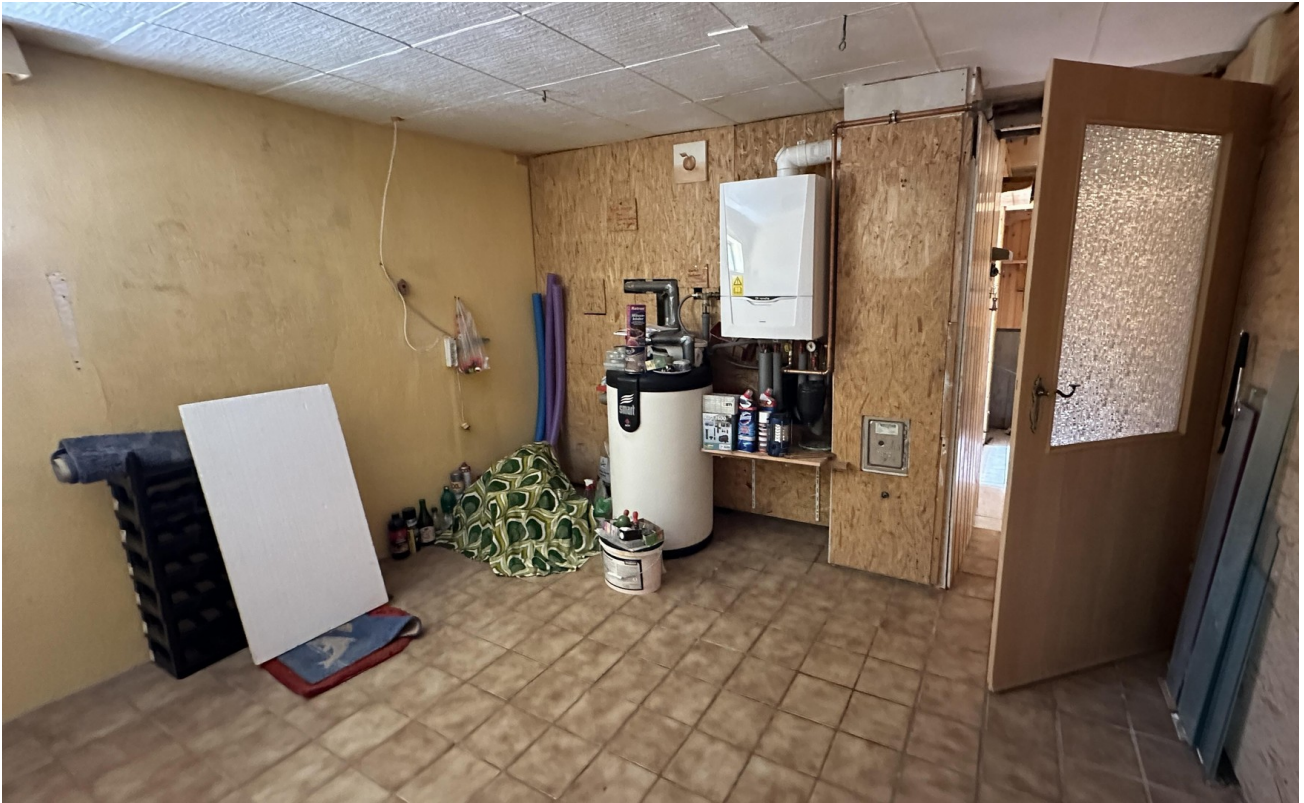
Ansicht der Heizungsanlage
