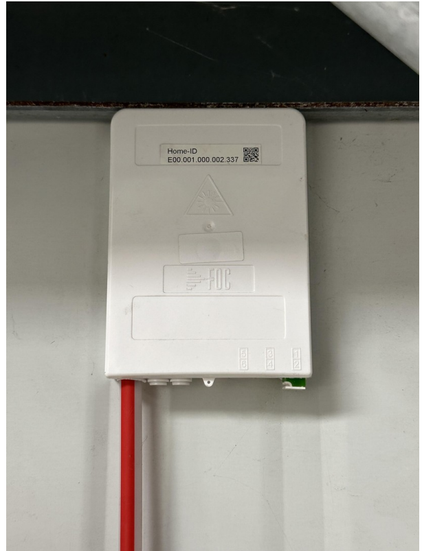
Halle 450 m Glasfaseranschluss
