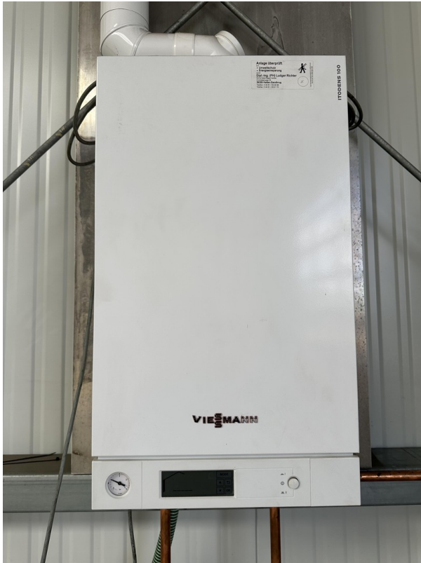
Halle 450 m 2 Gasheizung 2024
