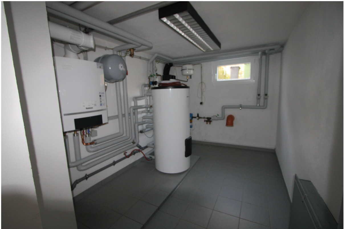
Heizung mit Solar
