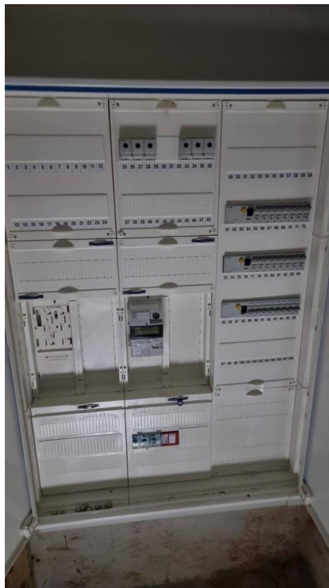
Neue Unterverteilung Strom
