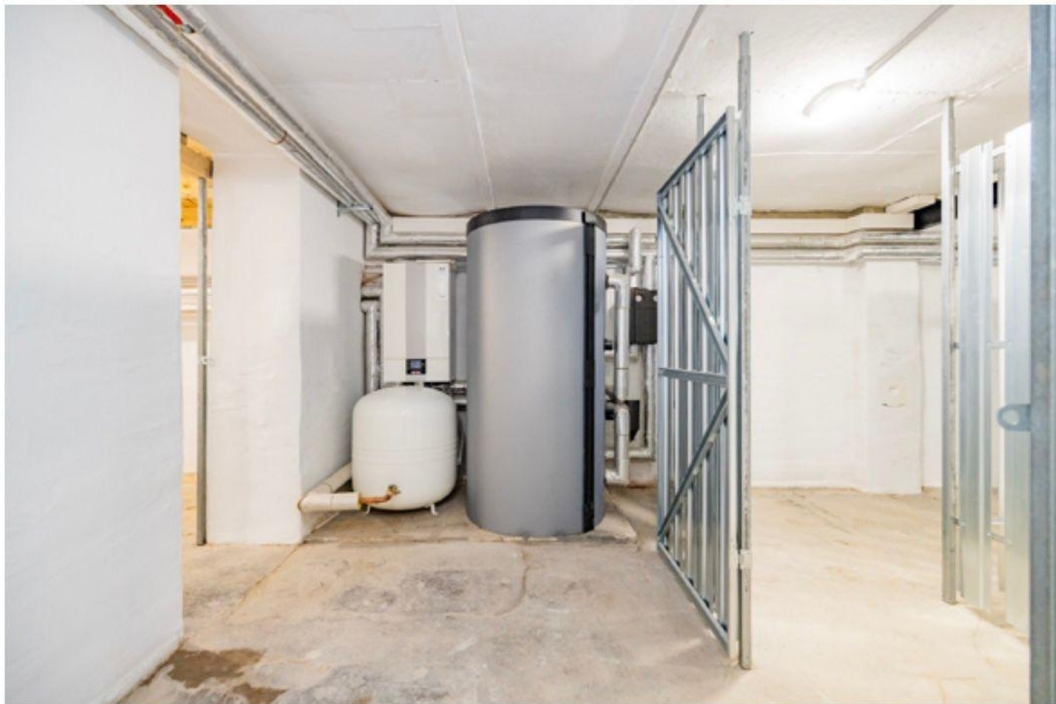
Keller mit neuer Heizanlage
