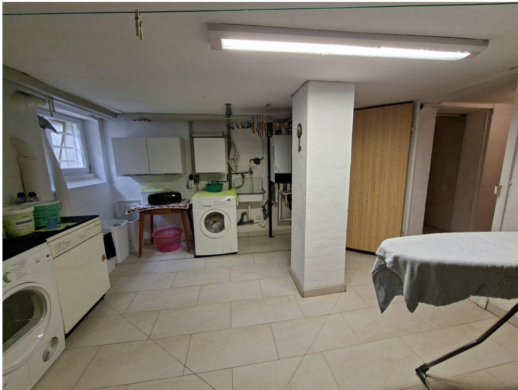
Keller Waschraum Heizung
