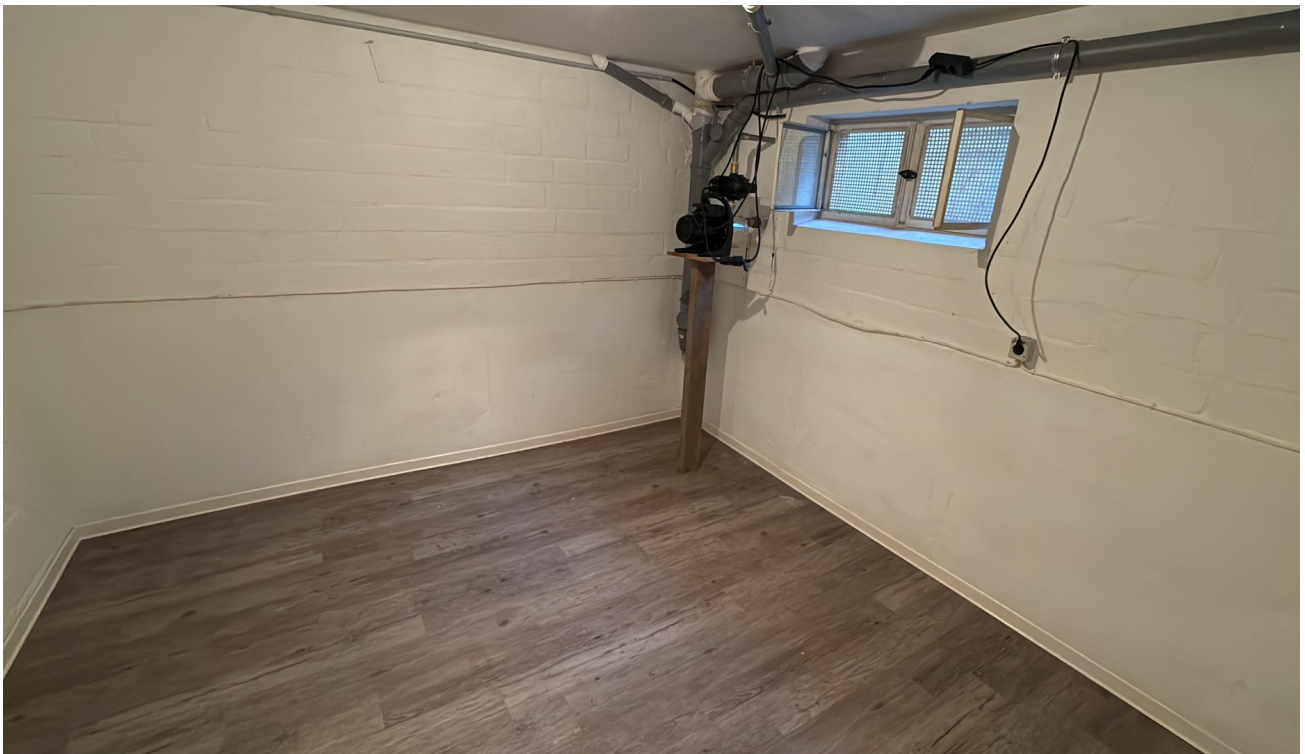
Keller mit Brunnenpumpe
