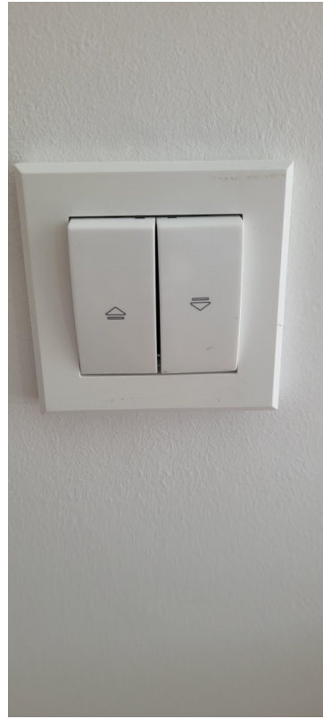
Elektrische Rollläden in Wohnr
