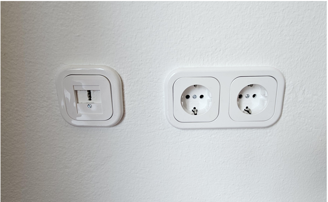
Neue Steckdosen und Schalter
