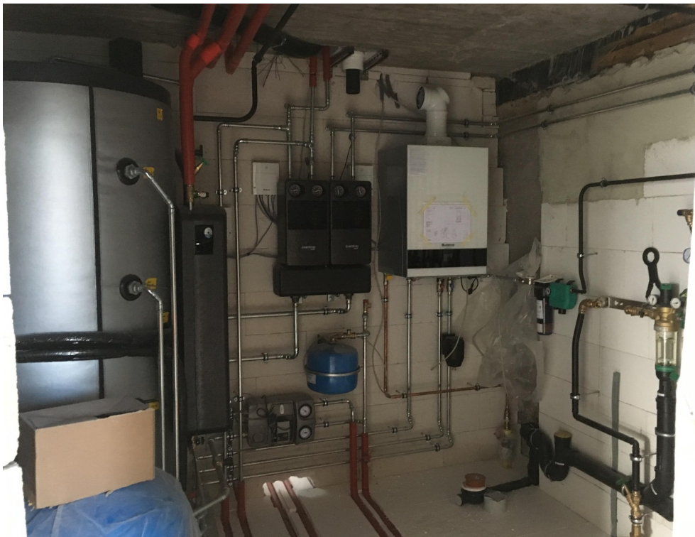
Technikraum Neubau + Altbau
