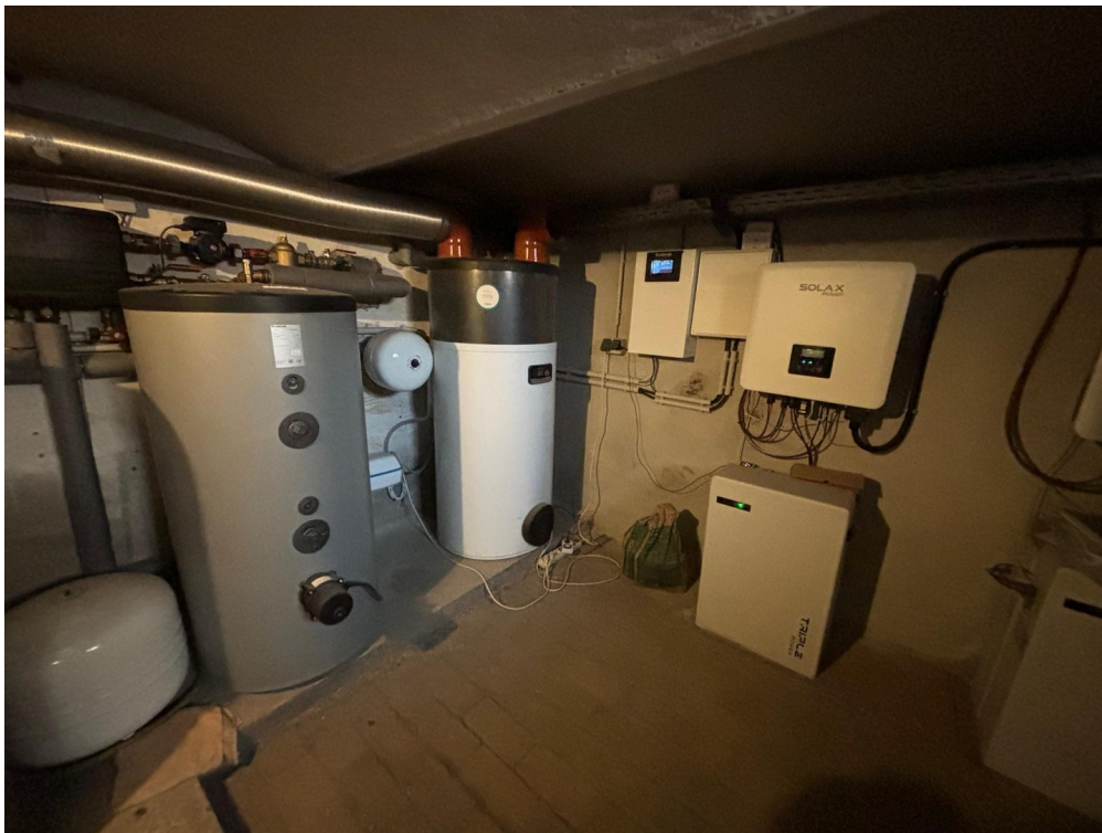
Pufferspeicher und Akkusystem
