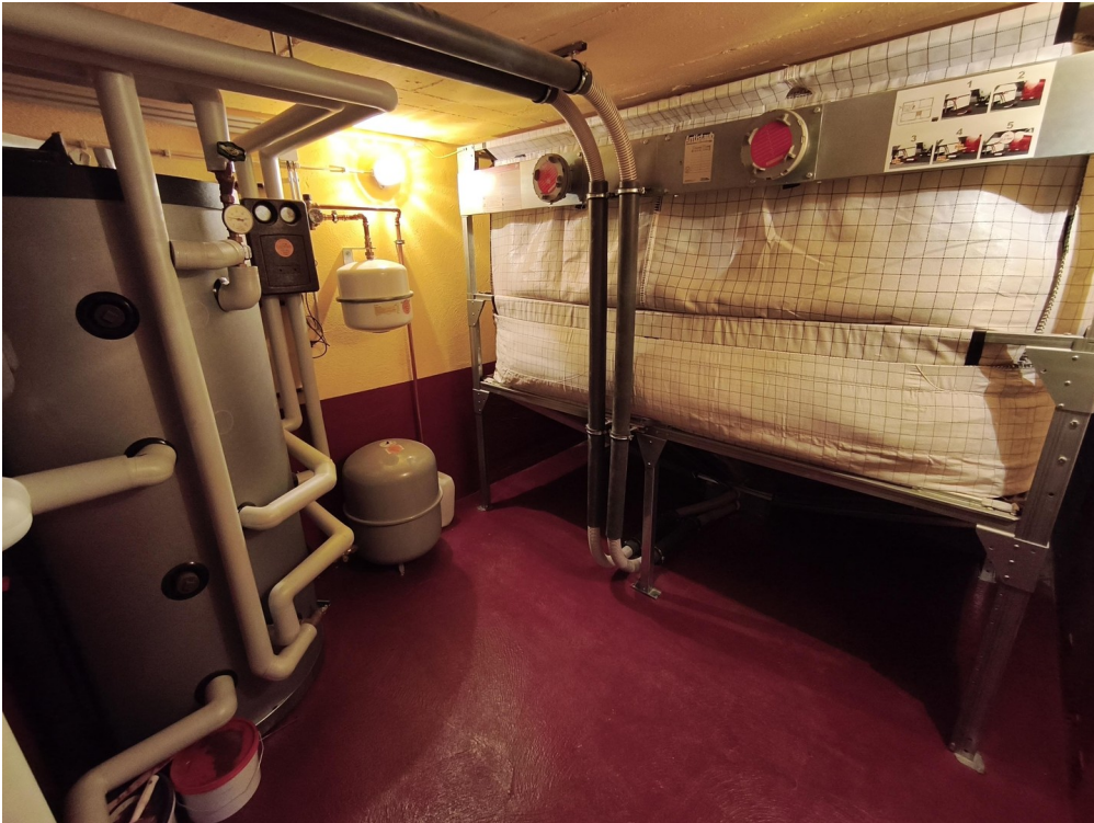
Brauchwasser und Pellettank
