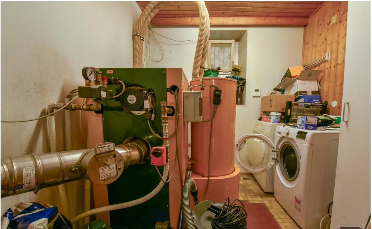
Heizungs- und Wasraum
