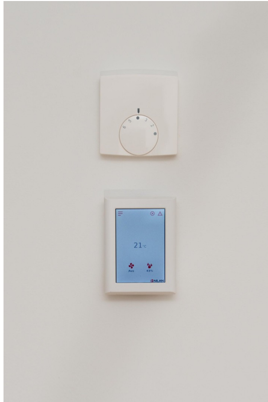
Be und Entlüftungsanlage
