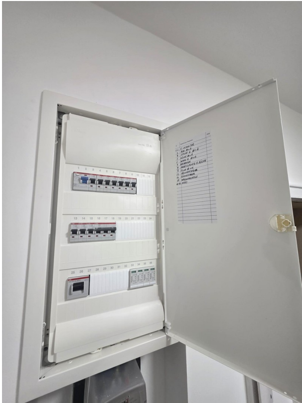
Neue Elektrik mit Schaltkasten
