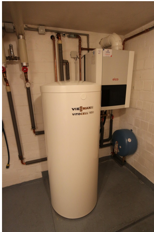
Heizungsanlage im Keller-2019
