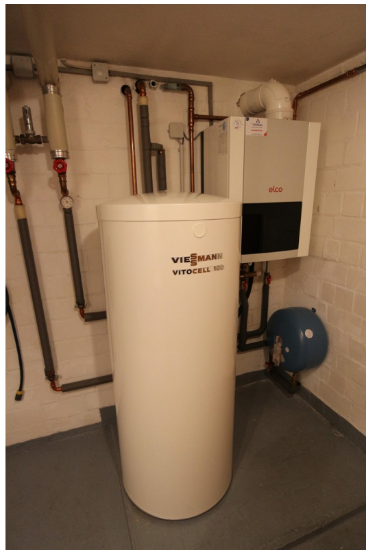
Heizungsanlage im Keller-2019
