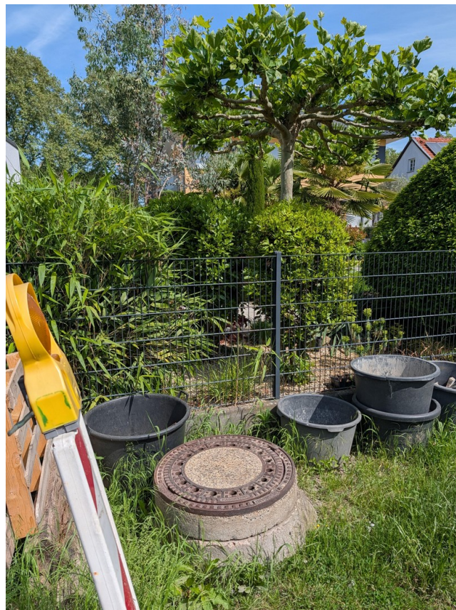
Kanalanschluss neben Zufahrt
