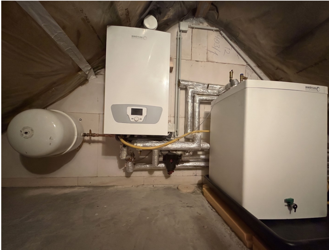
Heizungsanlage im Dachspitz
