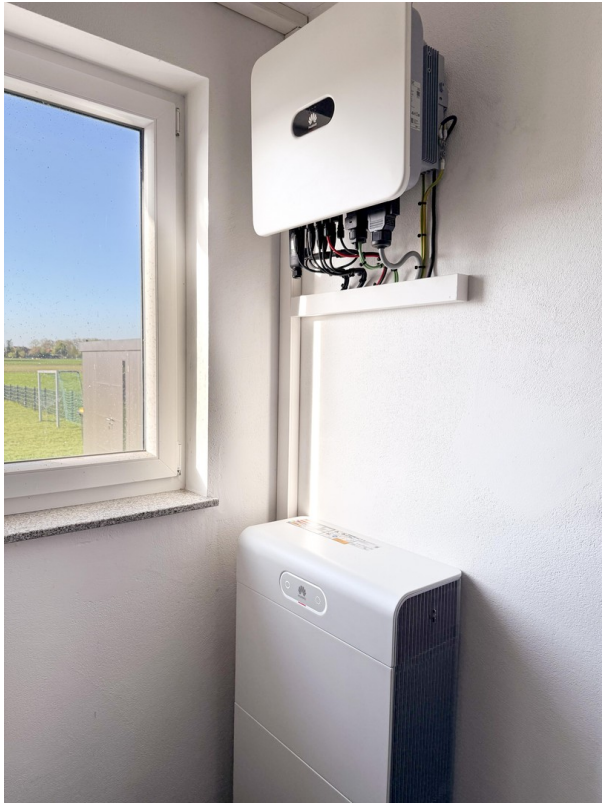
PV-Anlage mit Akku
