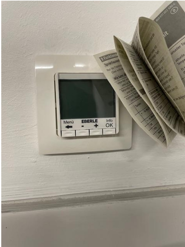
Fußbodenerwärmung Bad EG
