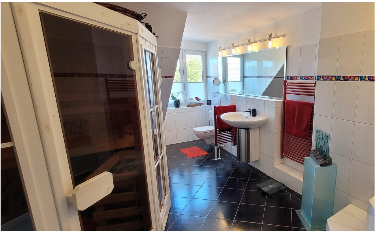
Bad mit FB-Heizung
