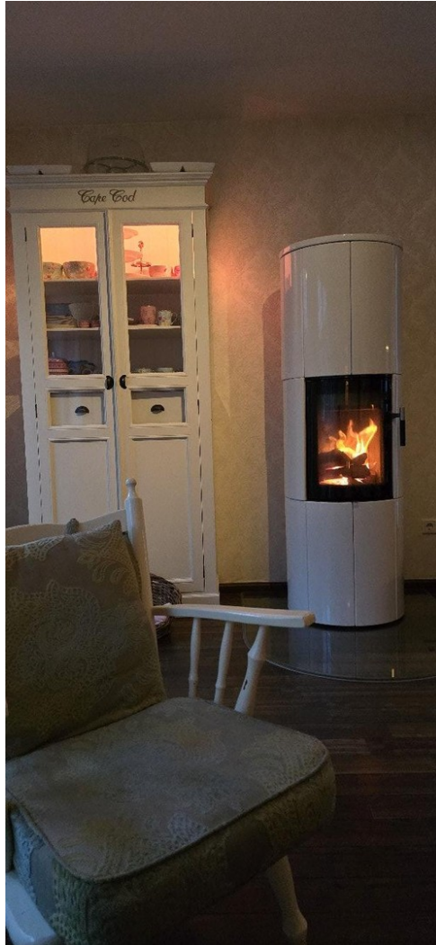
Kamin für schöne wärme
