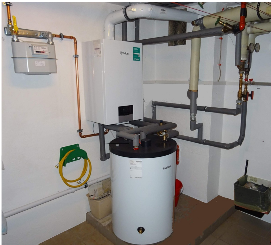
Heizung im Keller
