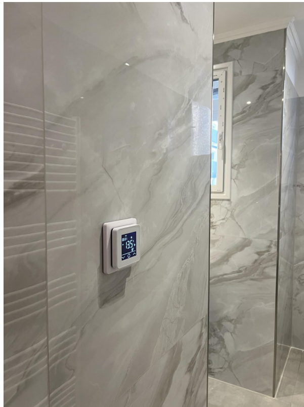
Fußbodenheizung im Bad
