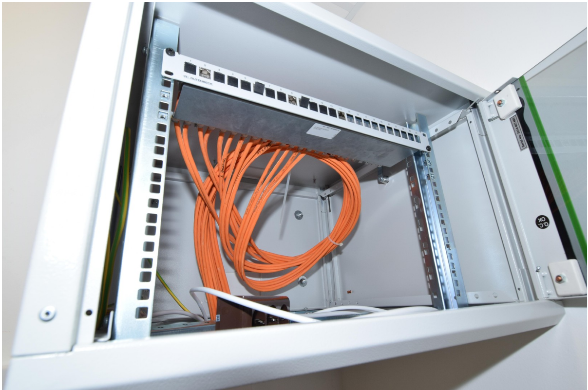
Serverraum und Technikraum
