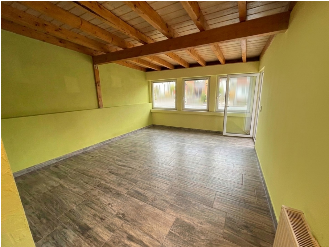
Anbau unten, Fußbodenheizung
