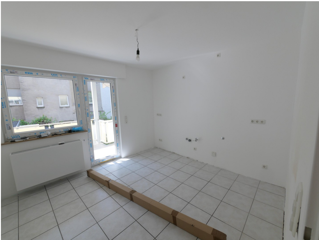
Küche mit Anschlüssen
