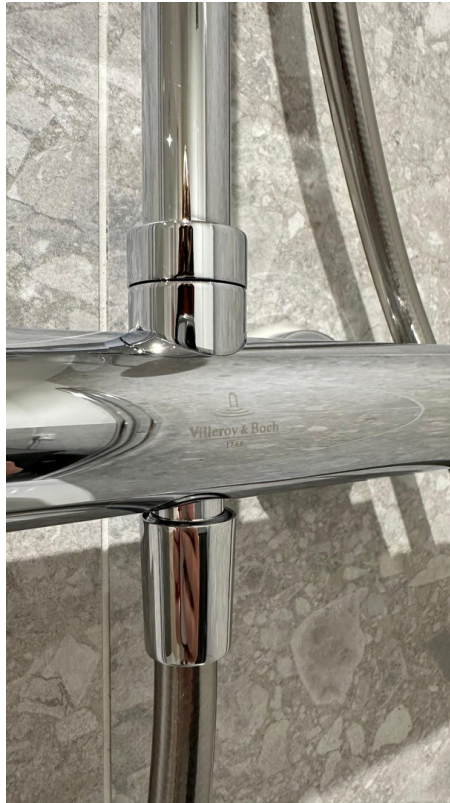
Bad Detailaufnahme Armatur
