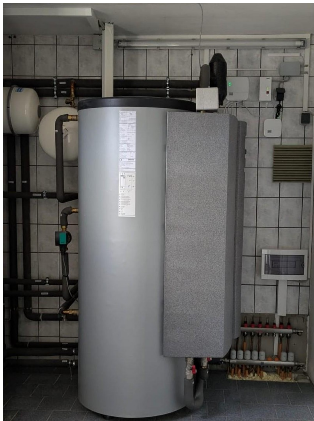
EG - HWR - Wärmepumpe
