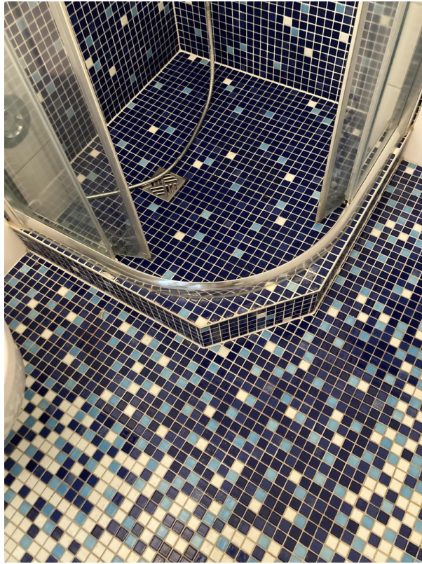
Bad: Mosaikarbeiten Boden
