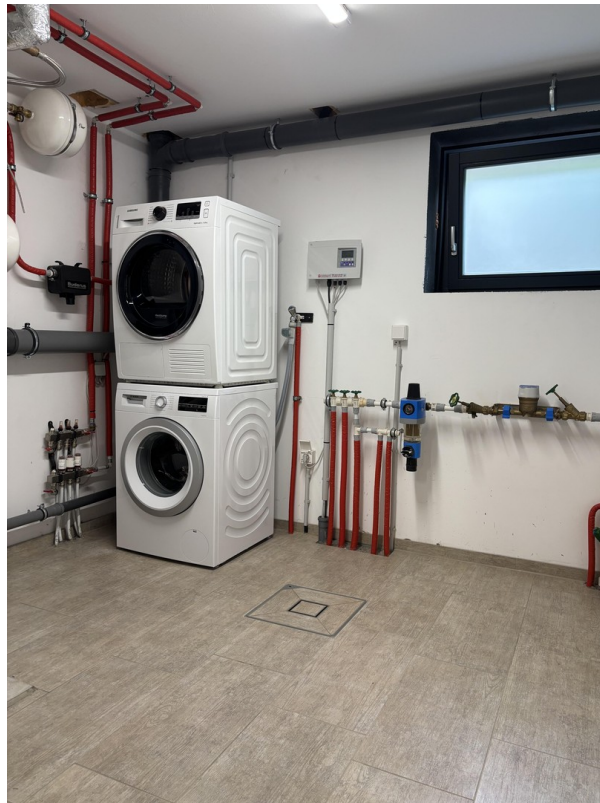
Wasch / Technikraum UG
