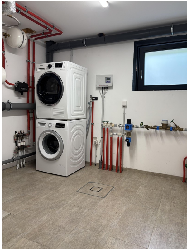
Wasch / Technikraum UG
