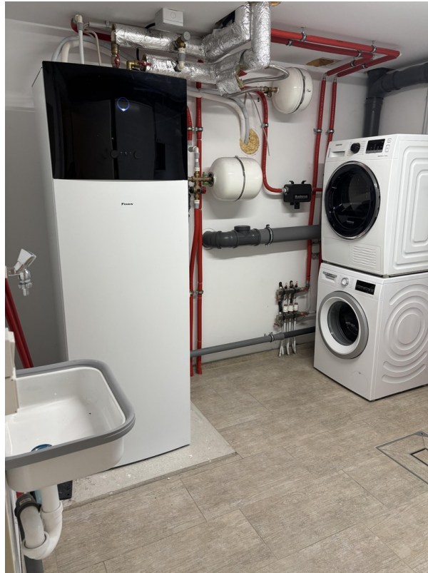
Wasch / Technikraum UG
