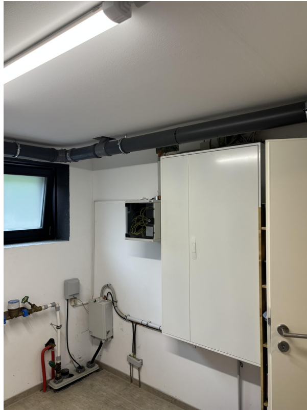
Wasch / Technikraum UG
