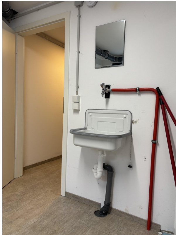
Wasch / Technikraum UG
