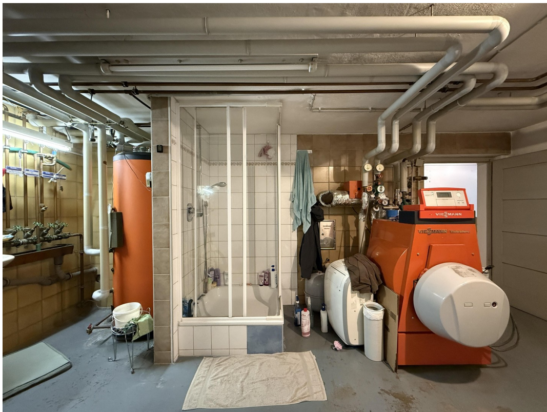
Heizraum und Dusche UG
