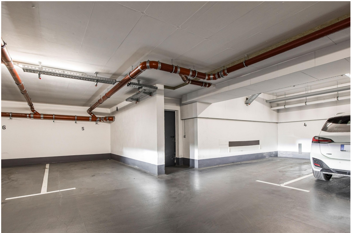
Tiefgarage mit Wallbox
