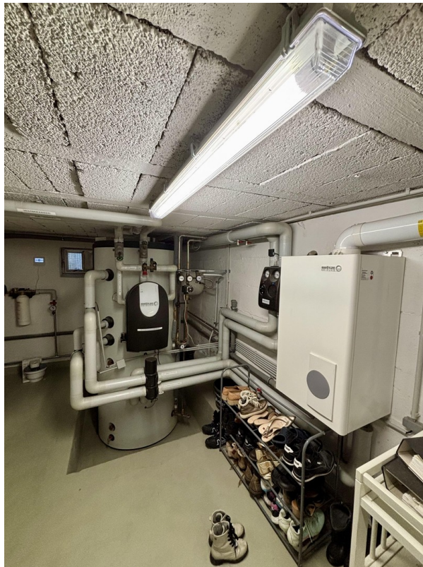
Hybrid-Heizungsanlage im KG
