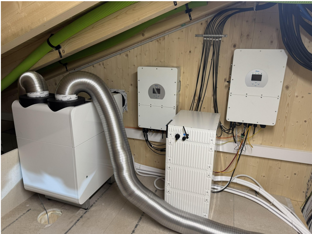
Dachboden PV Speicher Lüftung
