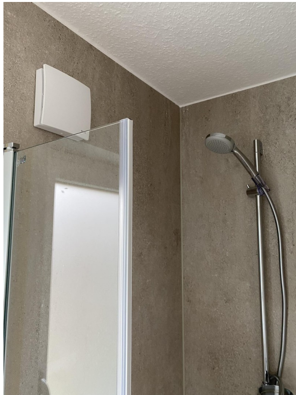
Dusche mit Lüfter
