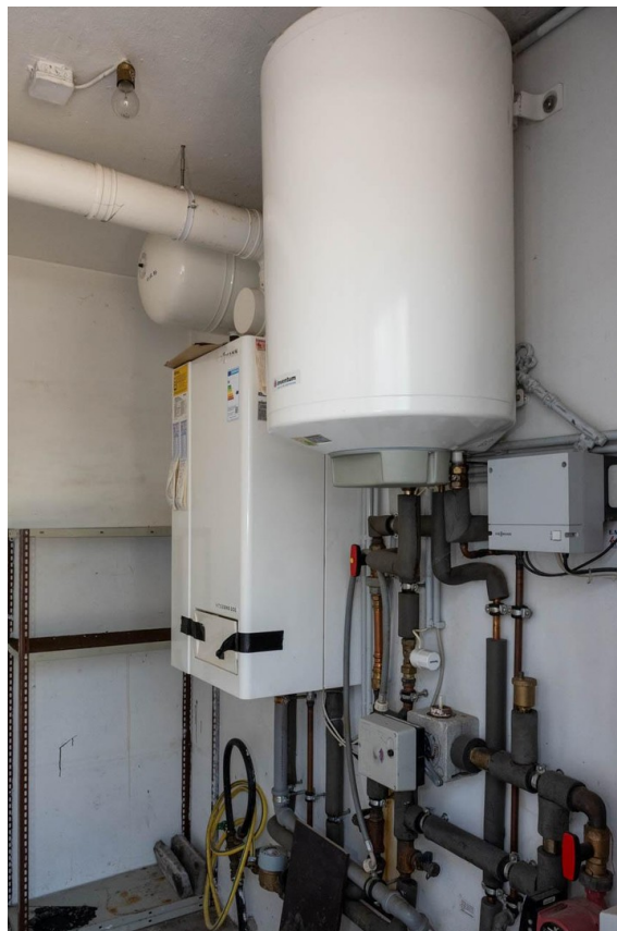
Viesmann Heizung im Nebenraum
