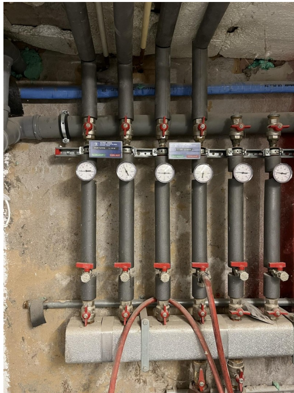
Verteilung vo der Heizung
