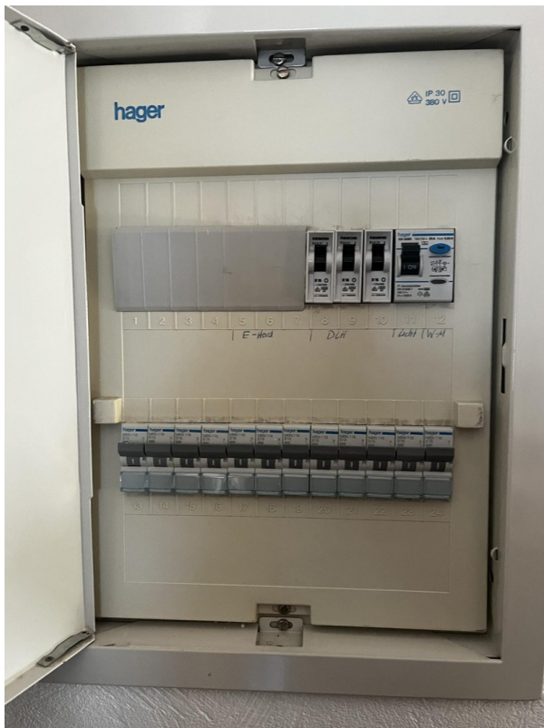
Elektro mit FI Schalter
