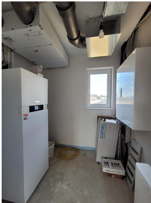
Haustechnikraum mit moderner H
