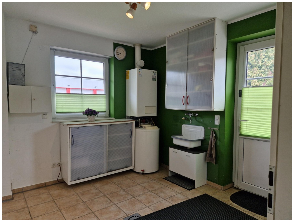
HWR mit Regenwasservorrüstung
