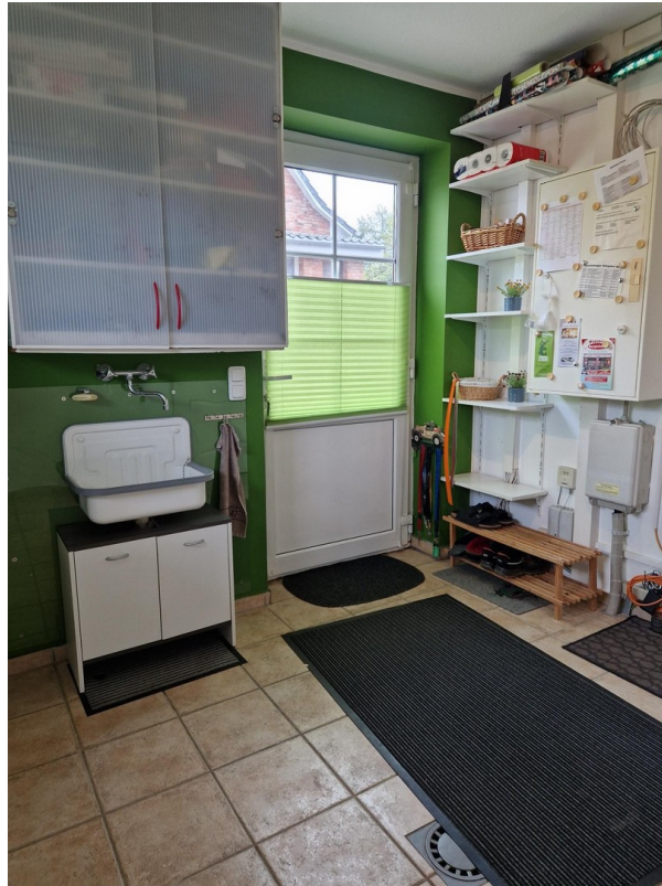
HWR mit Solar vorrüstung
