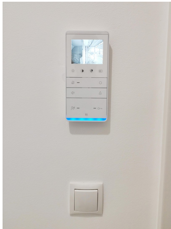
Gegensprechanlage im Flur
