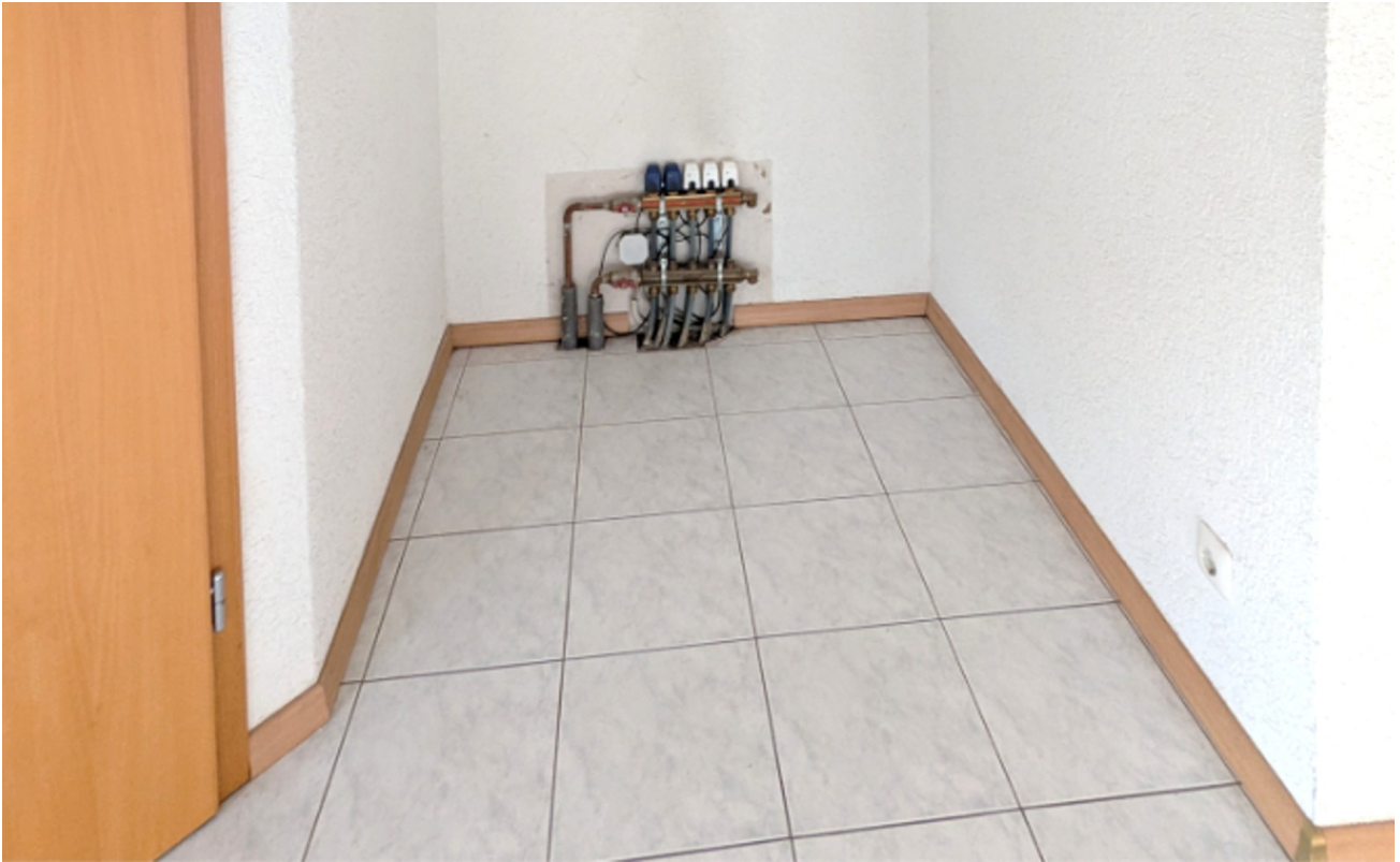
EG Ventile Fußbodenheizung
