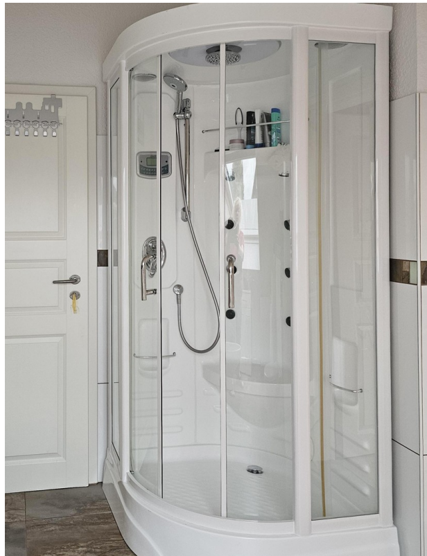
Duschbad im OG - Dampfdusche
