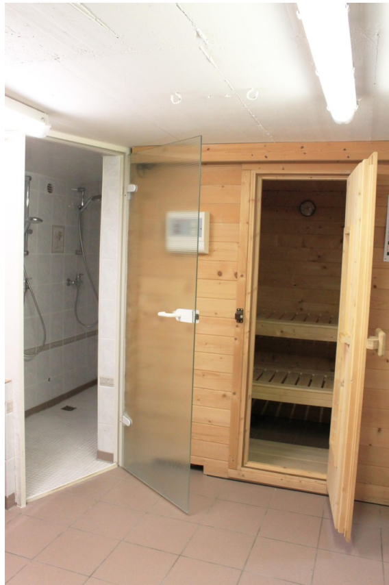
Sauna und Dampfbad/Dusche UG
