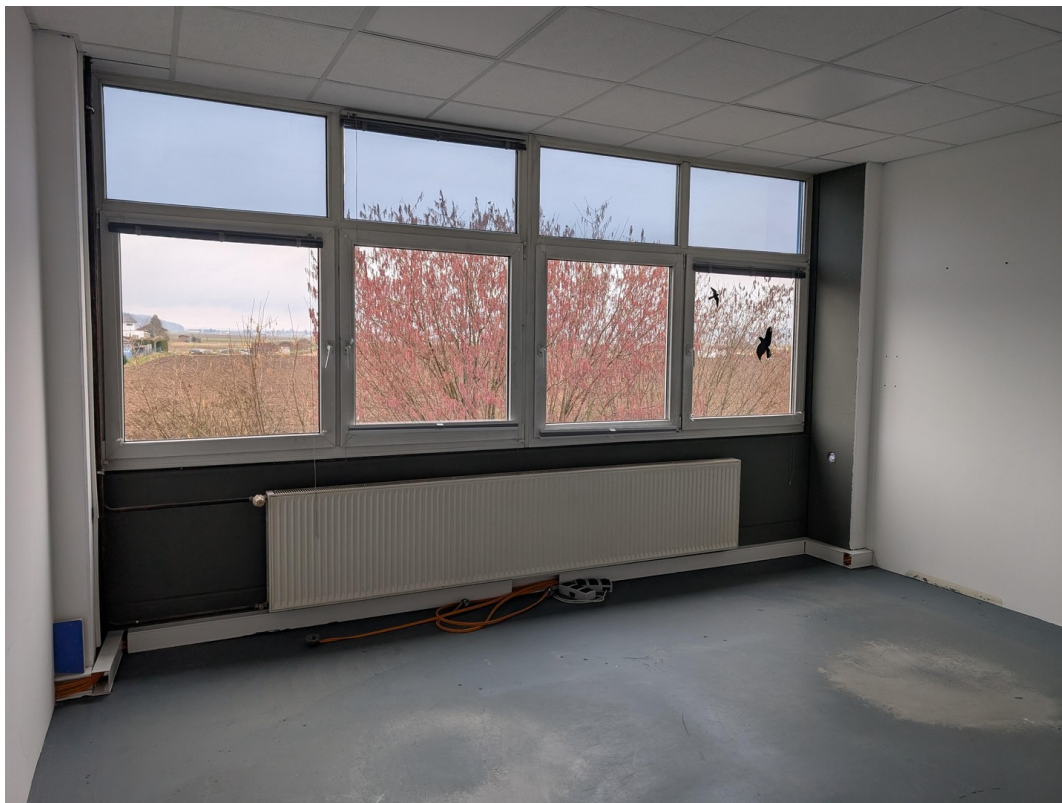
OG: Klimatisierte Büros (2v3)
