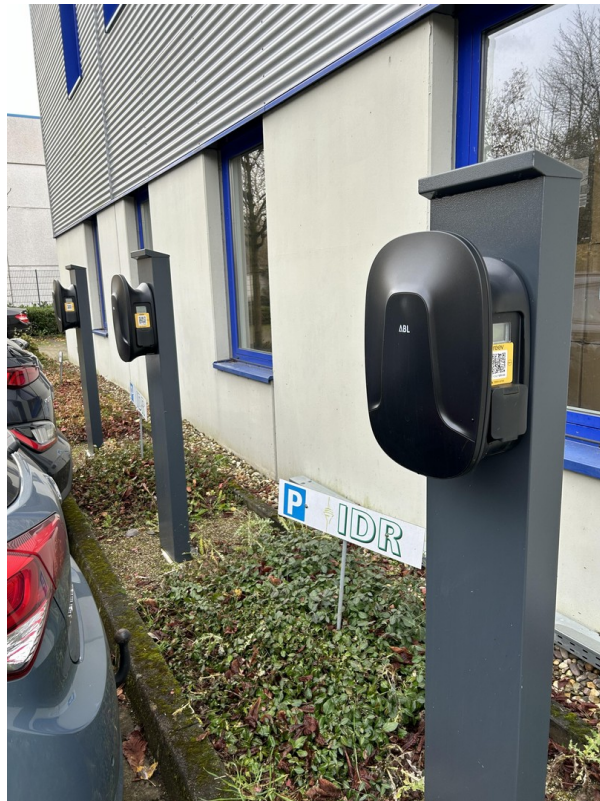
Parkplatz mit Wallbox (2 Stck)
