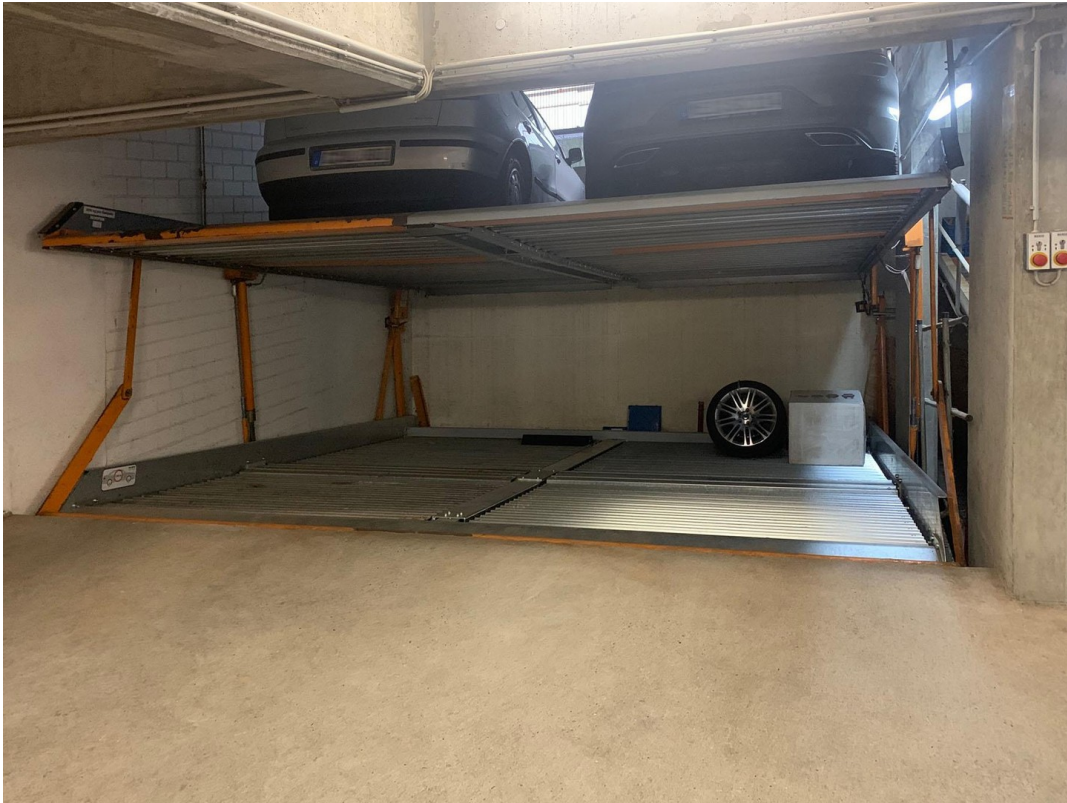
Duplex Parkplatz in Tiefgarage
