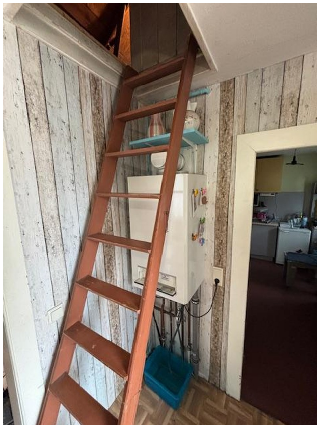
Flur mit Gas-Therme
