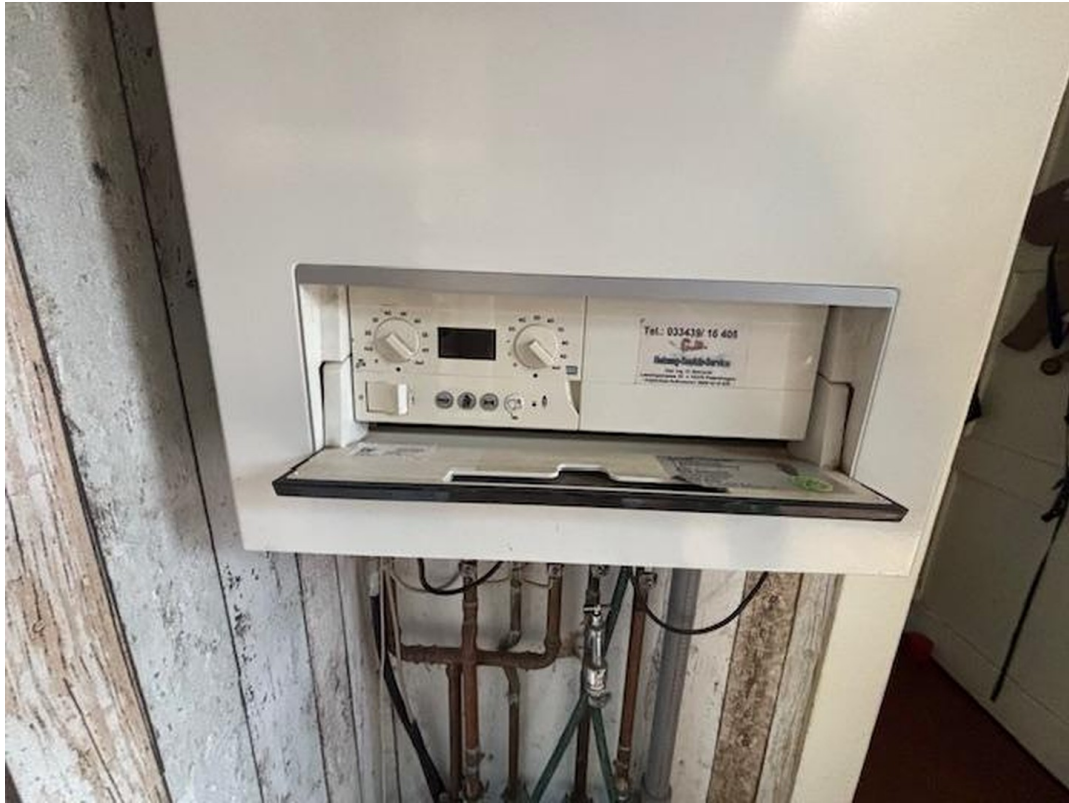
Flur mit Gas-Therme
