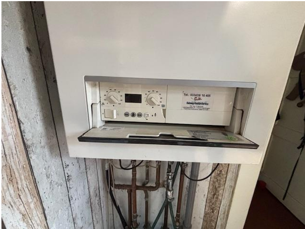
Flur mit Gas-Therme
