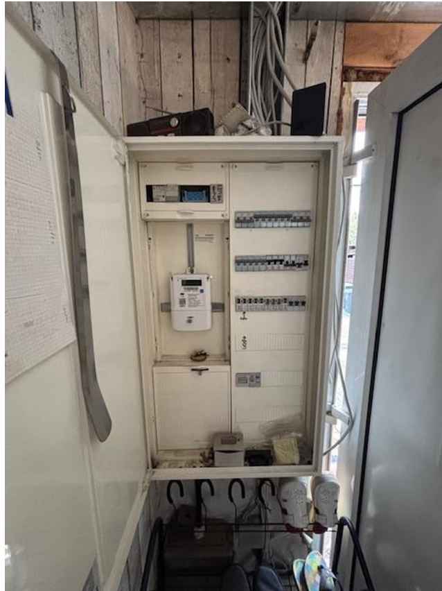
Flur mit Elektroschrank
